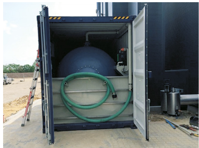
RYS. 5.7 Instalacja Storaagetank jako rozwiązanie kontenerowe. ZDJĘCIE Kemira.
